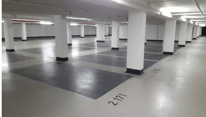
Tiefgarage Rathaus - Hilden Projektleiter – AMP Parking Europe GmbH
