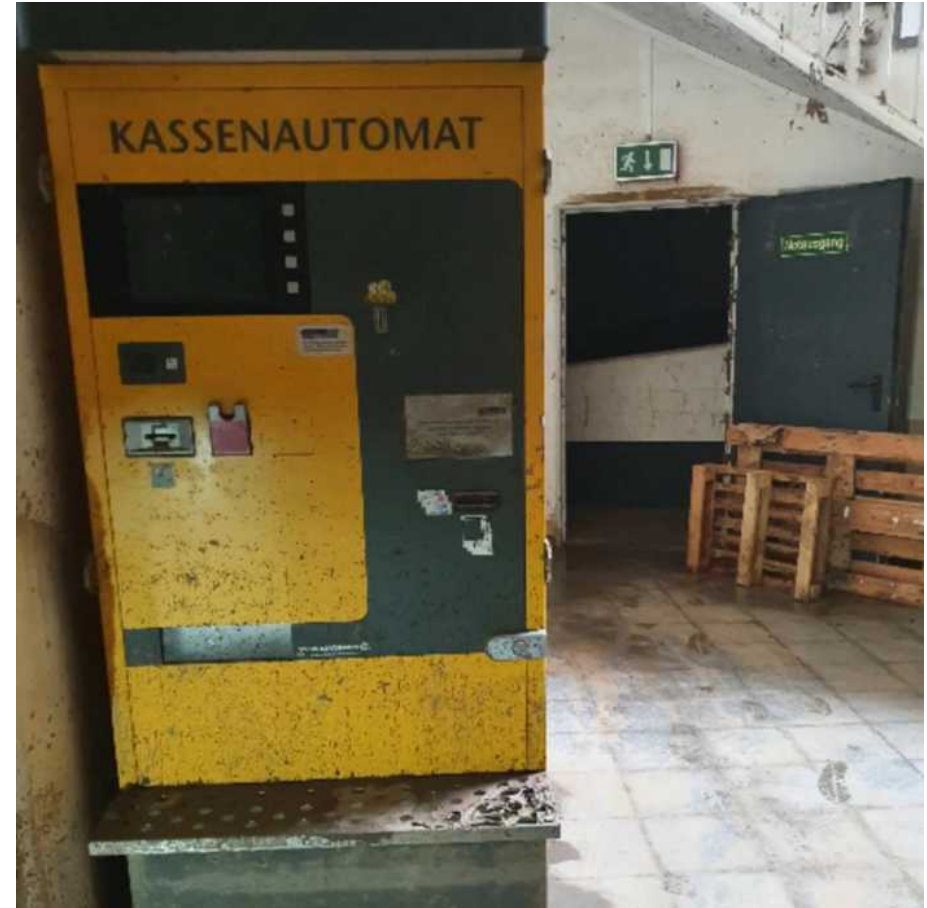
Hilden – Tiefgarage Nove-Mesto-Platz
